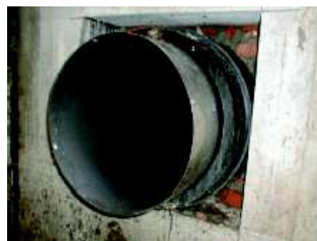
WaStop Ø 500 instalovaný na odtoku z havarijního přepadu.
