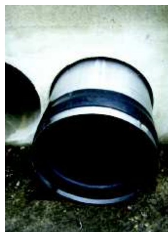
WaStop Ø 600 instalovaný na odtokovém potrubí. Tímto způsobem chrání ČOV před možným zaplavením.
