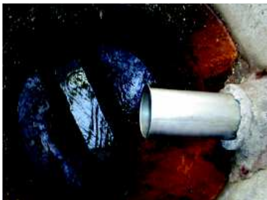
WaStop Ø 150 instalovaný na společné kanalizaci pro zamezení zpětného toku do splaškové kanalizace.
